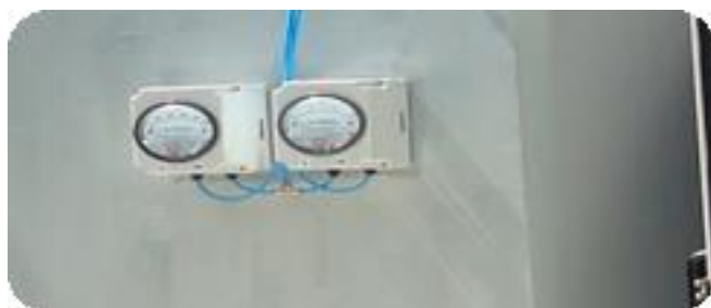
Sistemi di controllo \Delta P filtri
